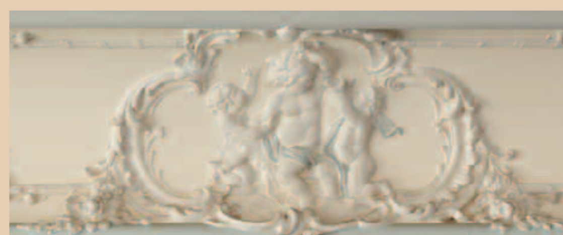
Décor de l'adoucissement du plafond d'une pièce du 1 er étage.
